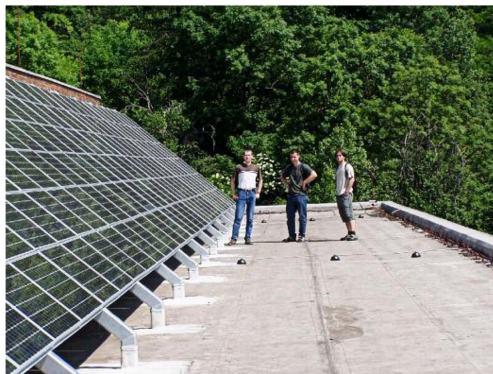
Obr. 14 Sluneční elektrárna na střeše budovy Matematicko-fyzikální fakulty v Praze Tróji. Výkon elektrárny postavené v roce 2003 je 20 kW.
